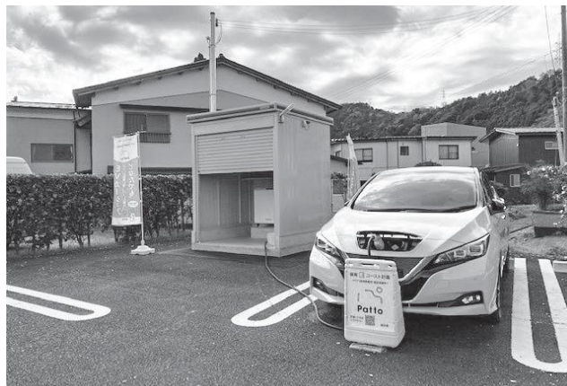
本郷駅駐車場に設置のEVステーション
